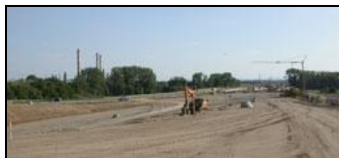
Obr. 37. Výstavba mimoúrovňové křižovatky u Opatovické elektrárny. Po jejím dokončení se již betonová lobby přesune blíže k Labi
